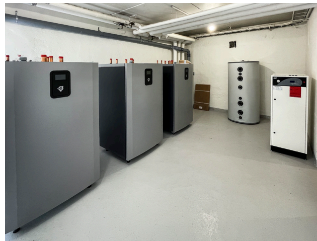
Miljön i pannrummet har blivit betydligt mycket bättre när bergvärmen kopplats in.
